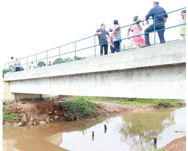
Construção da ponte sobre o Córrego do Descanso, em Babaçulândia/TO, facilita a integração das comunidades rurais
